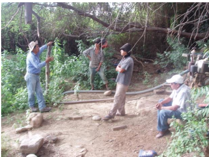
VERIFICACION FUENTE DE AGUA PARA RIEGO POR GOTEO
